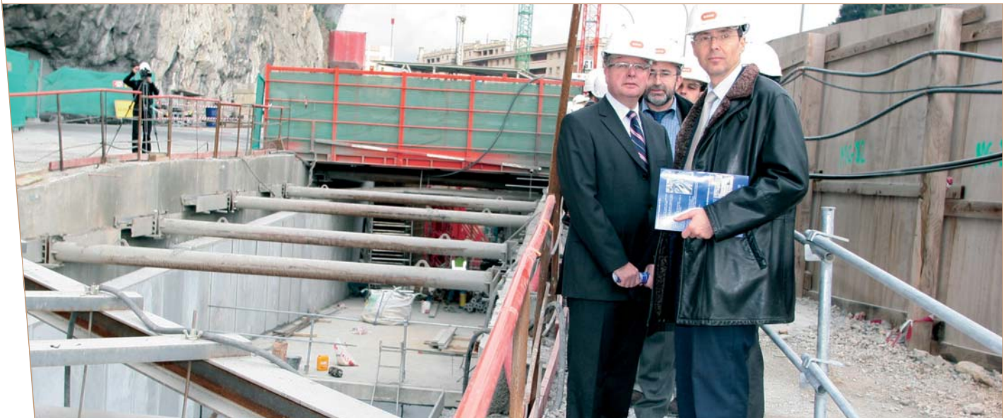
Le chantier T33 a reçu en janvier 2007 le "label bleu" pour ses efforts en matière de qualité, de sécurité et de protection de l'environnement.
