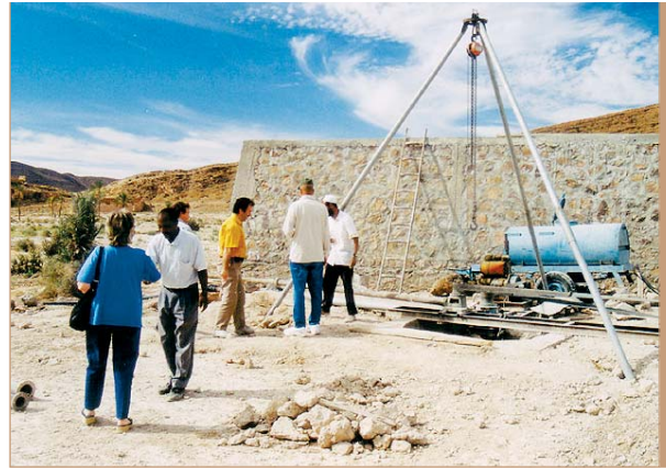
Bassin d'accumulation de la Palmeraie de Boumazir au Maroc.
